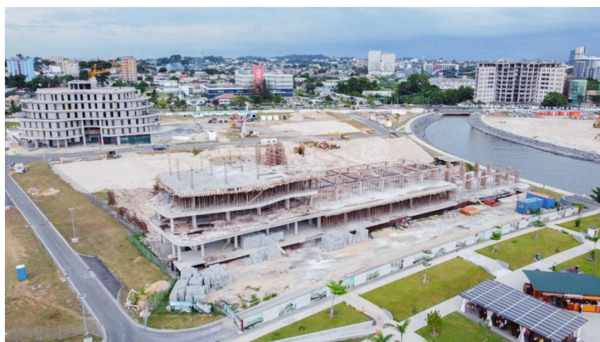
Figure 30 État d'avancement des travaux sur le site de la Baie des Rois à Libreville
